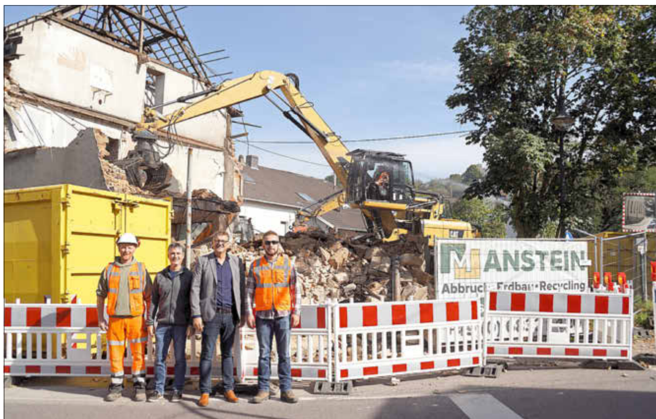
Der Unternehmer Max Manstein (rechts) und ein Mitarbeiter (links) erläuterten Bürgermeister Thomas Collmann (2.v.r) und Gemeindevbauingenieur Martin Speicher (2.v.l.) die angelaufenen Abbrucharbeiten mit schwerem Gerät
