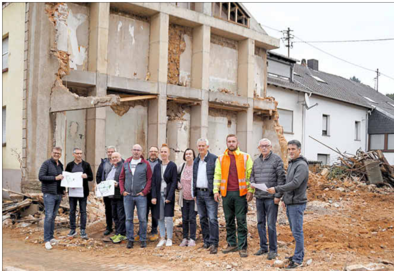
Ortsvorsteher Thomas Ackermann war mit seinem Stellvertreter Jürgen Bohr sowie seinen Ortsratskolleginnen und -kollegen am zweiten Tag an der Baustelle. Mit dabei waren auch wieder der Unternehmer Max Manstein, Bürgermeister Thomas Collmann und Gemeindevbauingenieur Martin Speicher
