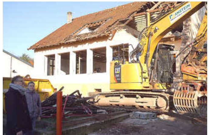
Mit einem Bagger führt die Firma Manstein derzeit die Abbrucharbeiten des Kita-Gebäudes St. Marzellus durch. Hierüber informierten sich Bürgermeister Thomas Collmann (links) und Gemeindebauingenieur Martin Speicher (rechts) vor Ort.
